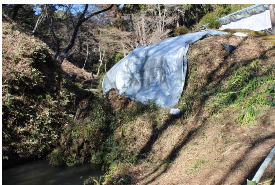
【崩落した築山】
