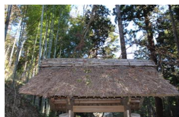
【通用門経年劣化した茅葺屋根】
